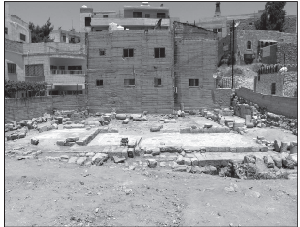
١١. واقع الحال بعد انتهاء أعمال التنظيف والترتيب للعناصر المعمارية وإزالة الطمم والنفايات من الموقع.
